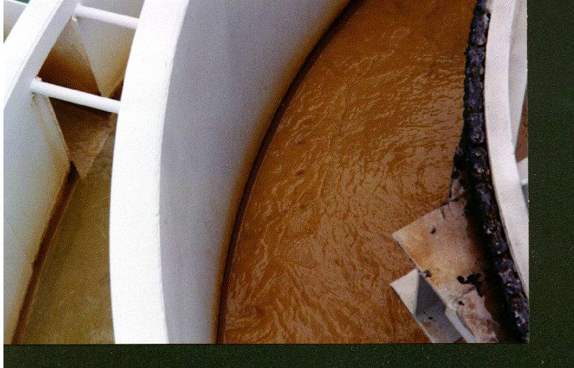
Εικόνα 1. Το νερό αναμιγνύεται με χλωριούχο σίδηρο και οξείδιο του ασβεστίου και στη συνέχεια ακολουθεί η κροκίδωση.
